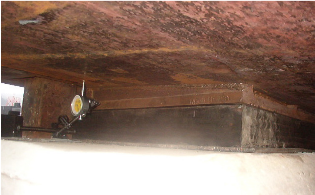
Foto 12. Estado actual apoyos de neopreno
