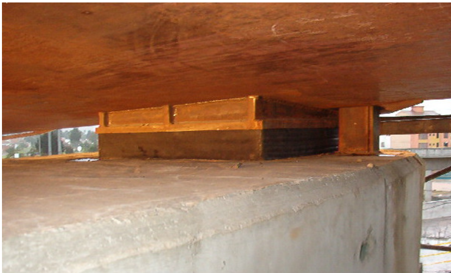
Foto 11. Estado actual apoyos de neopreno
